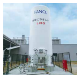
滋賀工場のLNGタンク(2022年7月よりカーボンニュートラルなLNGを補充開始)
